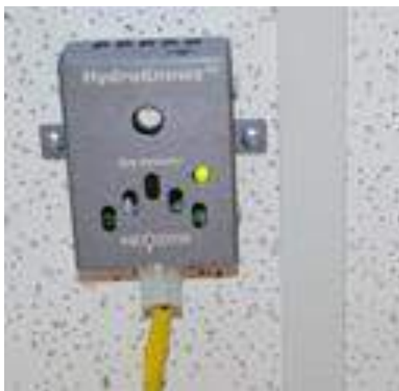
Figura 4.1: Detector de hidrógeno 400 ppm
