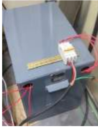
Figura 5.5 Transformador para el convertidor del lado de la red.
